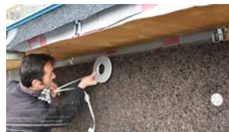
10. Posa del nastro espandente TECNOTAPE nei punti di contatto tra isolante e superfici rigide e sporgenti
